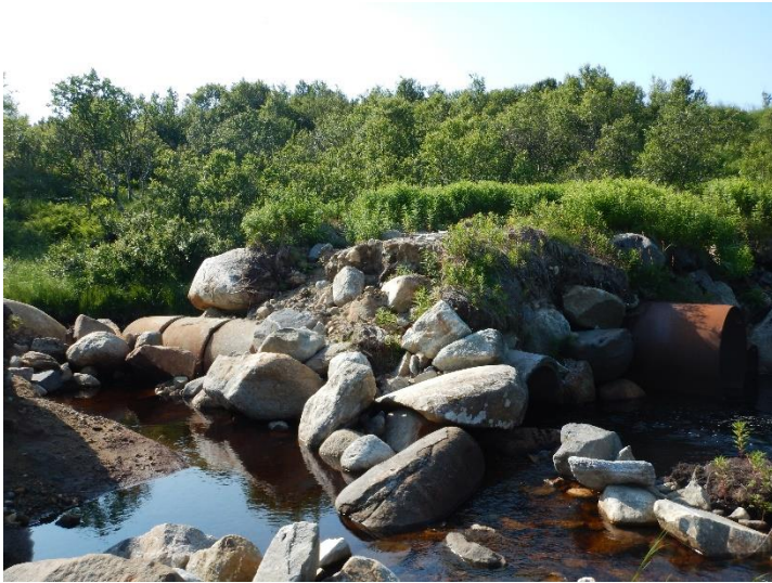
Utrast vei med kulverter
