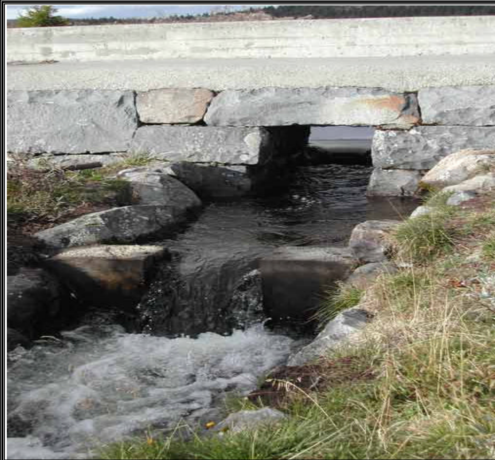
Bilde 11 Innløpet til fiskerenna i Melsjøen (øverst). De to inntakene til fiskerenna i Melsjøen (nederst).
