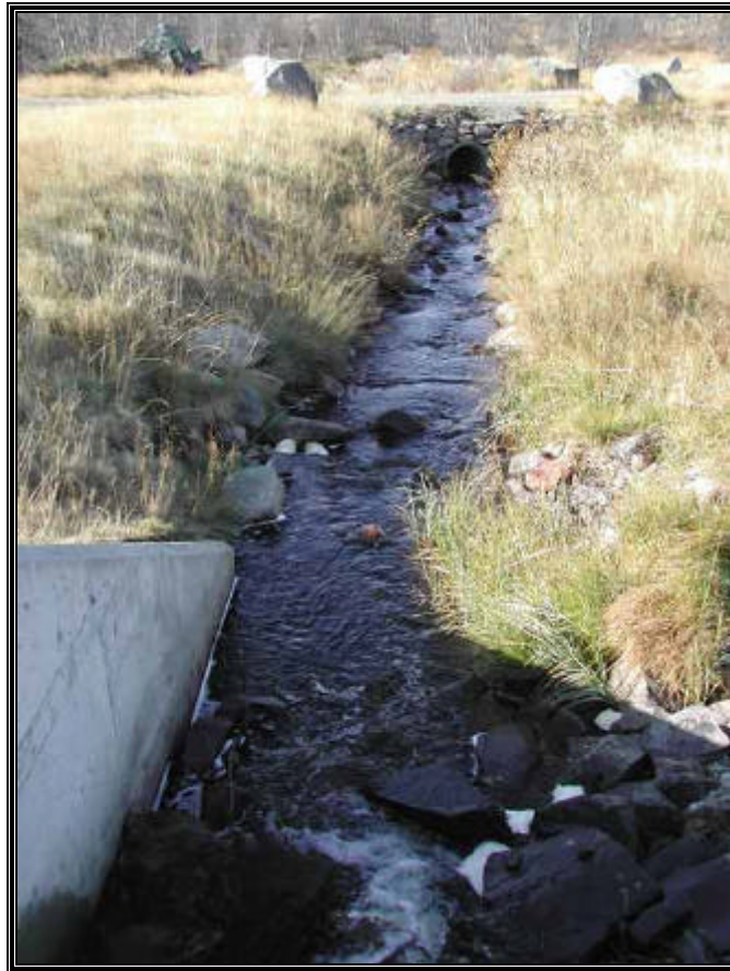
Bilde 7 Dammen på Våsjøen med utløpsåpningen for vann til fiskerenna (nederst) og fiskerenna i Våsjøen sett nedover (øverst).
