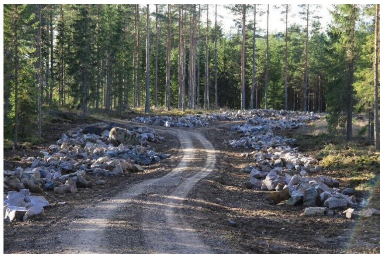
Ombygging av veg i steinrik morene med mye stein i overflata og oppe på bakken.
