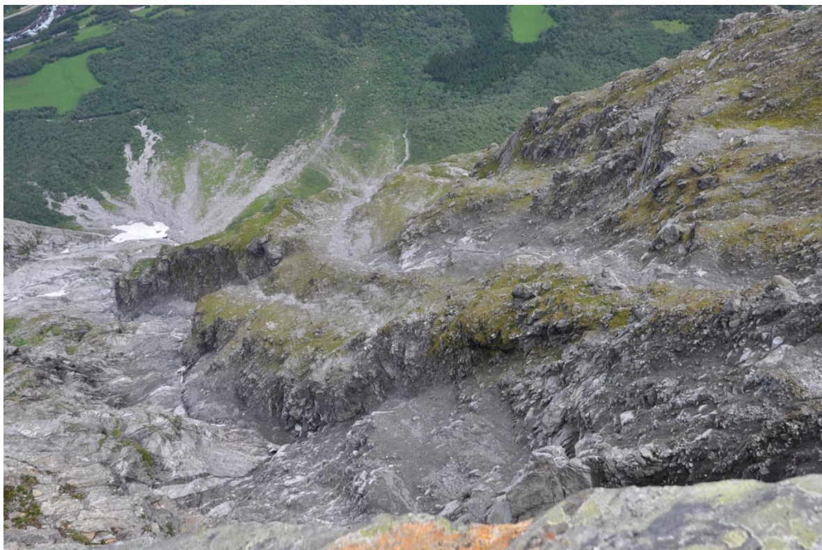
FIGUR 10. AKTIVT OMRÅDE I VESTLEG DEL AV DET USTABILE OMRÅDET. LEGG MERKE TIL STORE UTGLIDINGSKANTER OG DEN AKTIVE SKREDVIFTA NEDE I ROMSDALEN.
