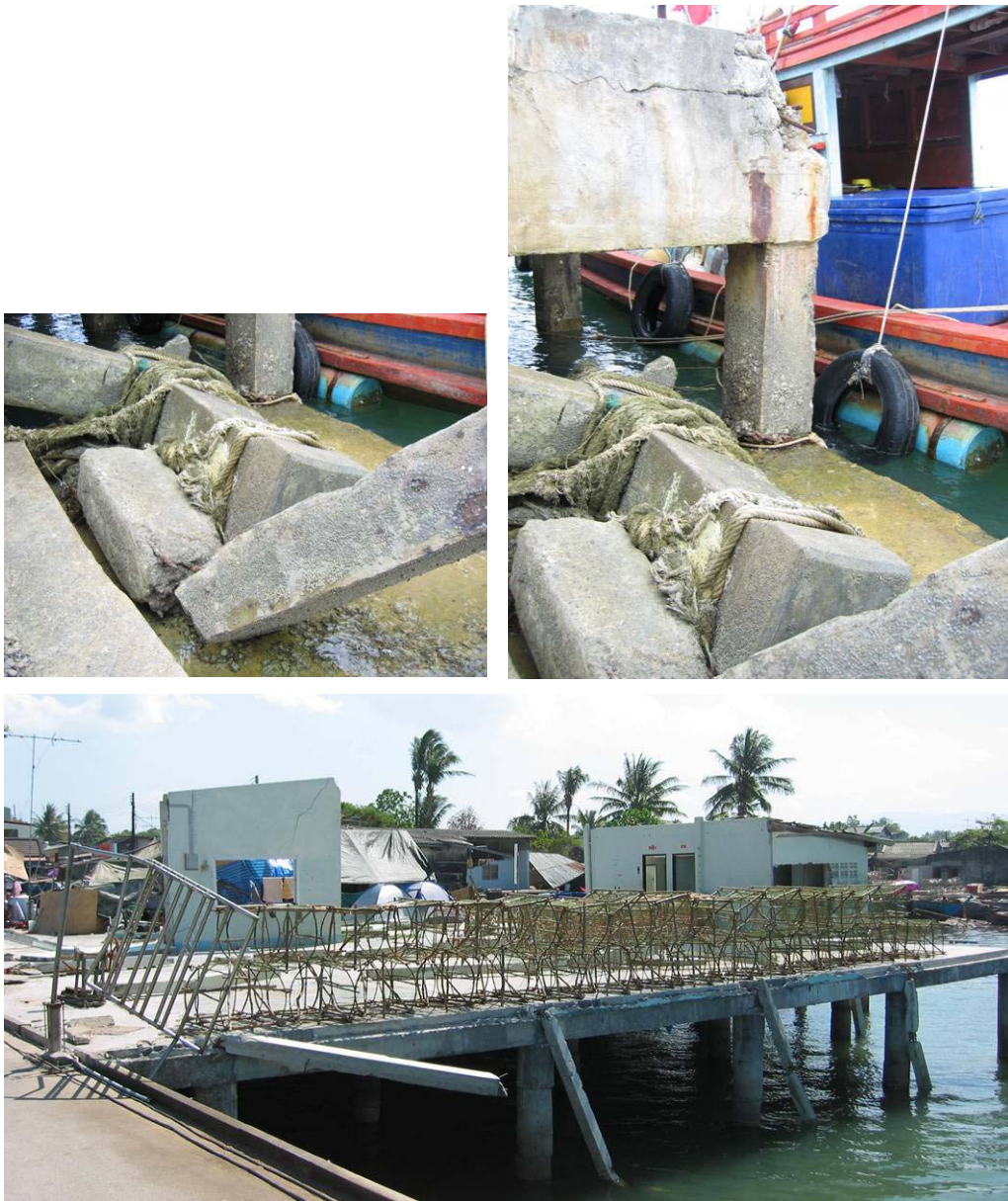
Figur 2.8: Eksempler på ødelagte kaikonstruksjoner i Nam Khem, Thailand, etter flodbølgen i desember 2004.
