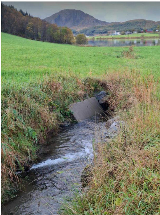
Bildet er tatt ovenfor et av rørene. Bekken har begynt å grave ut sedimenter på siden av røret, noe som på sikt kan føre til at dette blir et vandringshinder for fisken.
