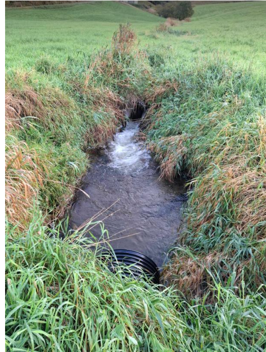
Bildet viser at store deler av bekkens naturlige elvebunn er beslaglagt av de erosjonshindrende tiltakene som er utført. Det ble observert to ørreter > 35 cm i kulpen på bildet.
