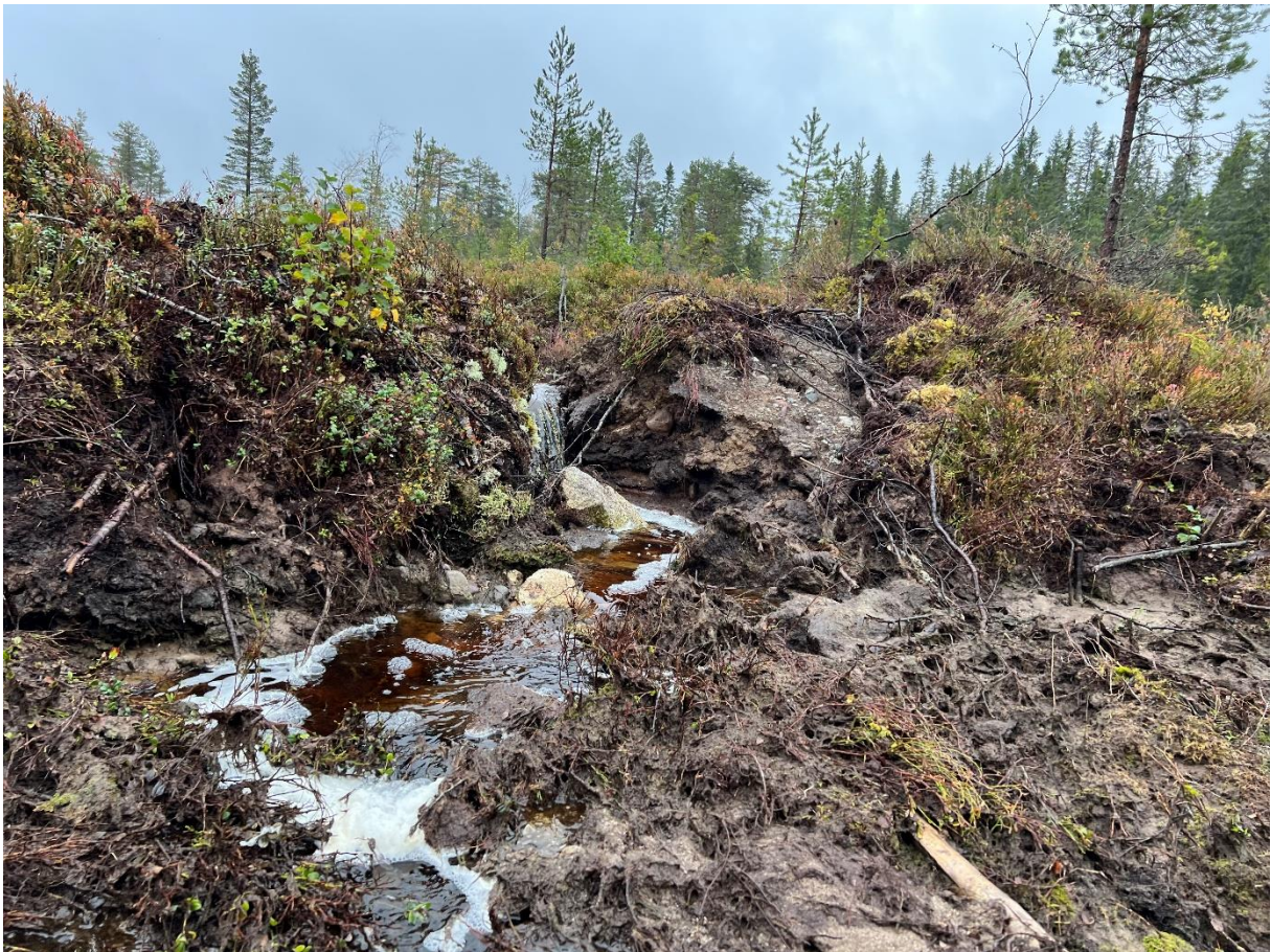
Figur 21: Stein i demning, som har ført til erosjon av torv og til slutt brudd. Foto: Suzanne Wien.
